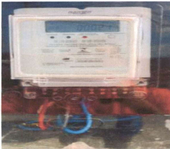
(Item 9.7) ENTRADA DE ENERGIA ELÉTRICA
