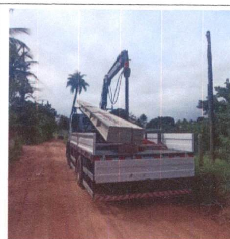
Foto 3: Poste de concreto. Comprova os itens 3.1 e 3.2.
