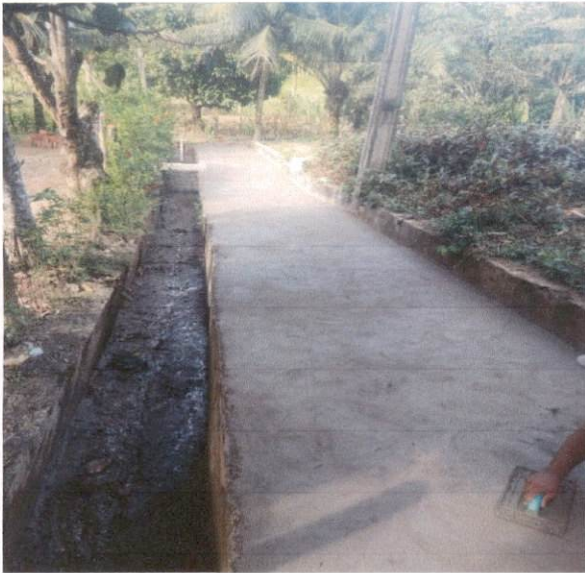
Item: 4.1 CONCRETO NAO ESTRUTURAL (1 4 8) PARA LASTROS DE PISOS E FUNDACOES, LANCADO E ADENSADO
