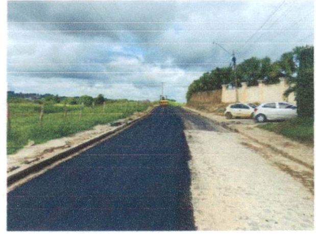
Item: 2.3.2 -EXECUÇÃO DE PAVIMENTO COM APLICAÇÃO DE CONCRETO ASFÁLTICO, CAMADA DE BINDER - EXCLUSIVE CARGA E TRANSPORTE. AF_11/2019
