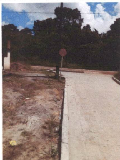
Descrição: RUA DO CAMPO (CHÃ DE CONSELHO) – 25.3.2 FORNECIMENTO E IMPLANTAÇÃO DE REGULAMENTAÇÃO EM AÇO, R1 LADO 0,248 M – PELÍCULA RETRORREFLETIVA TIPO I E SI
