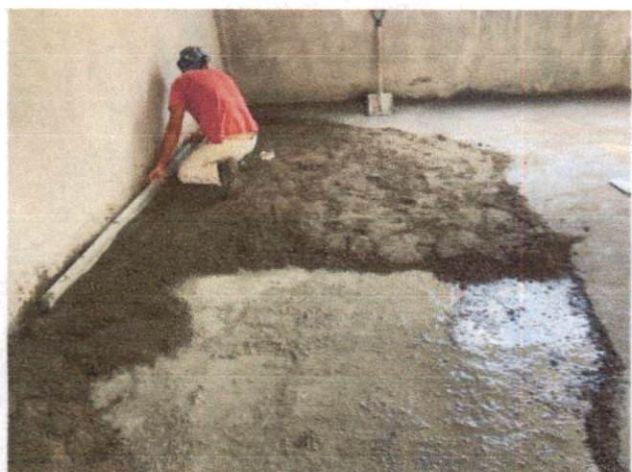
Foto 3: Contrapiso em argamassa traço 1:4 (cimento e areia), aplicado em áreas secas sobre laje, espessura 5 cm. (Item 9.1.2)
