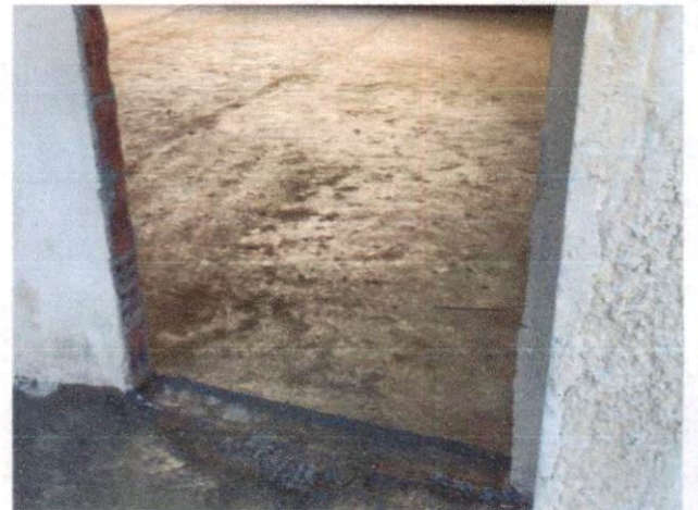
Foto 8: Contrapiso em argamassa traço 1:4 (cimento e areia), aplicado em áreas secas sobre laje, espessura 5 cm. (Item 9.1.2)
