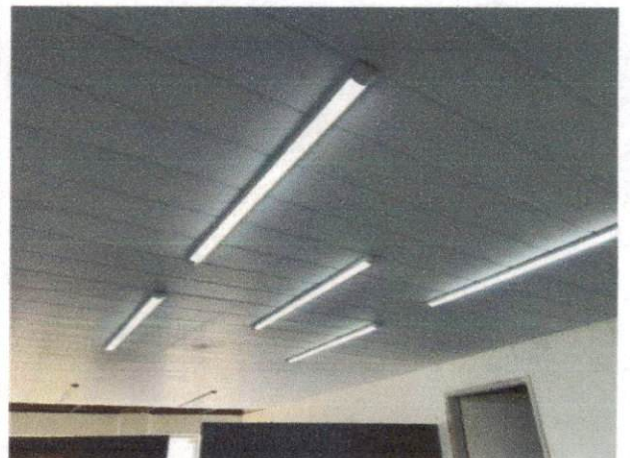
Foto 12: Luminárias tipo calha, de sobrepor, de LED 36 W, fornecimento e instalação. (Item 10.3)
