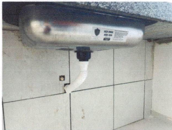
Foto 18: Cuba de embutir de aço inoxidável, incluso válvula tipo americana em metal cromado e sifão flexível em PVC, fornecimento e instalação (Item 11.12)
