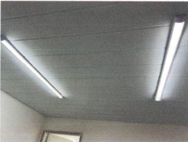
Foto 11: Luminárias tipo calha, de sobrepor, de LED 36 W, fornecimento e instalação. (Item 10.3)
