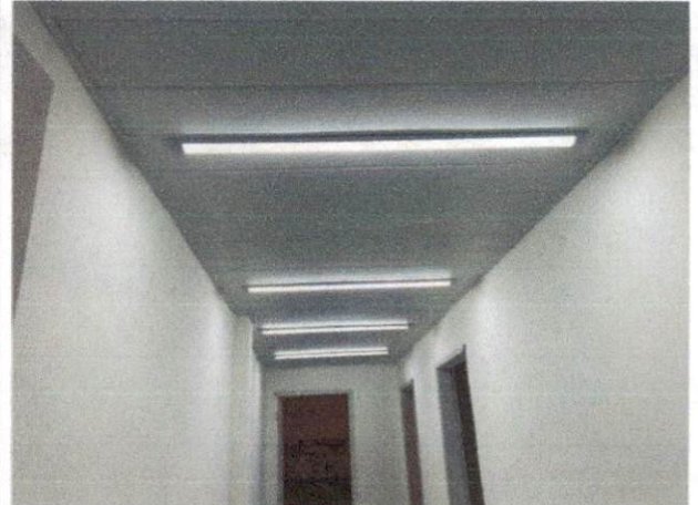
Foto 10: Luminárias tipo calha, de sobrepor, de LED 36 W, fornecimento e instalação. (Item 10.3)
