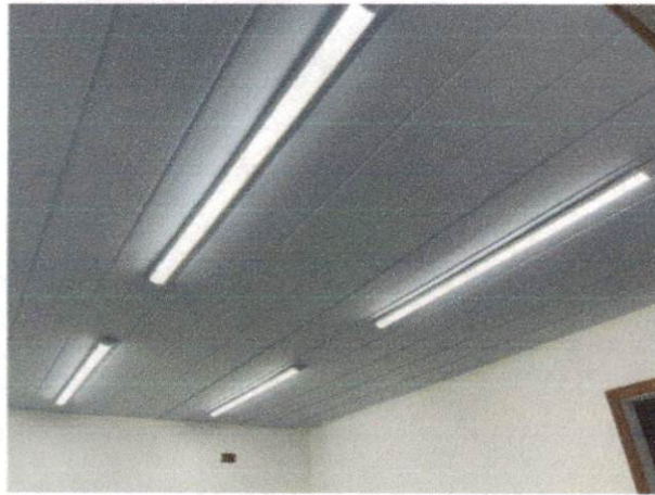
Foto 9: Luminárias tipo calha, de sobrepor, de LED 36 W, fornecimento e instalação. (Item 10.3)
